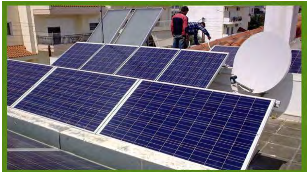
Δηθύια 1.13 Φσηνβνιηαηθά Σπζηήκαηα ζε ζεγέο. Πεγή: http://www.greenprogress.gr/fotovoltaika-sto-geraka.php
